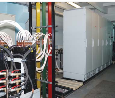
Стенд токовых испытаний систем возбуждения
